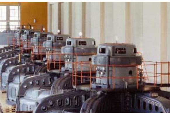
Turbine im Wasserkraftwerk Mühleberg
