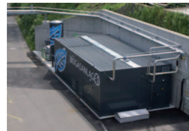
Biogasveredelungsanlage, speist seit 2007 Gas ins Netz der EWB ein.
