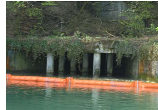
Ölsperre beim Auslaufbauwerk Eymatt
