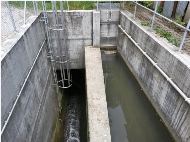
Blick in Fliessrichtung, Entlastung Stadtbach im Bereich Kleefeld. Rechts: Stadtbach mit Drosselschieber. Links: Entlastungskanal Richtung Wohlensee (Foto: Frank Marti)
