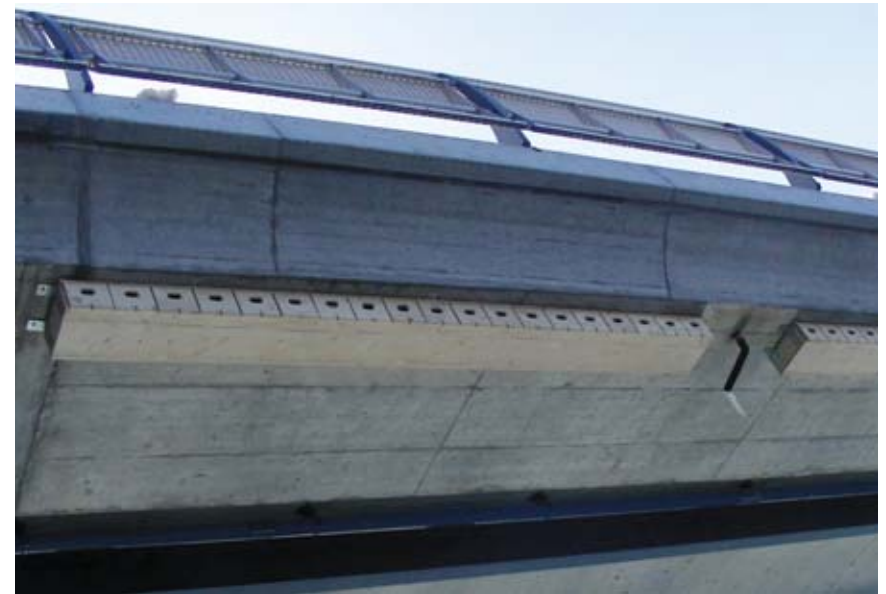
Mauersegler-Nistkästen an der Unterseite der Wehrbrücke.
