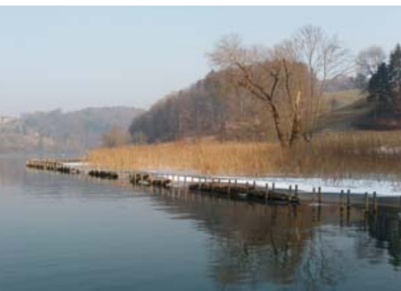
Lahnung vor der Instandstellung.
